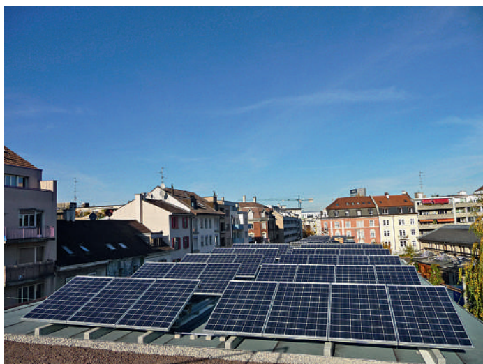
Figure 3 Installation photovoltaïque dans le quartier de Gundeldingerfeld à Bâle (© Martin Vosseler).
